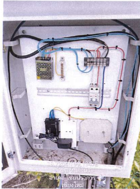
รูปภาพภายในตู้ก่อนเปลี่ยนอุปกรณ์
