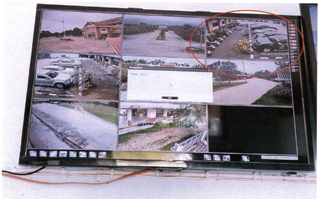
รูปภาพกล้อง CCTV หลังจากตรวจสอบ ที่ใช้งานได้ปกติ
